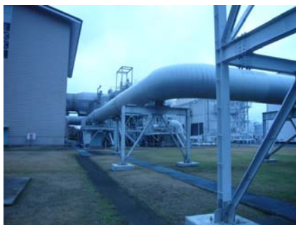
写真 7-27 蒸気輸送管（滝上地熱発電所）
