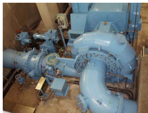
写真 7-22 第一水道発電所の発電機
