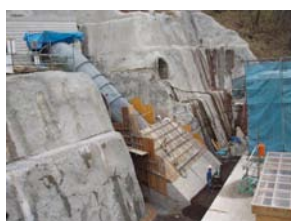
左：水圧管路、右：サージタンク
