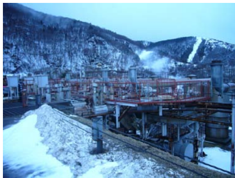
写真 7-25 八丁原発電所の生産基地
