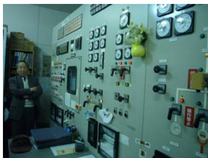
写真 7-26 九重観光ホテルの発電制御盤
