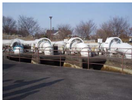
写真 7-12 天狗岩水力発電所
