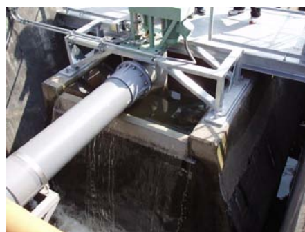
写真 7-9 伊勢崎浄化センターの水力発電機
