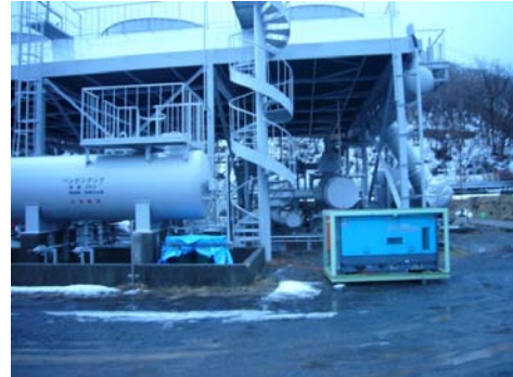
写真 八丁原発電所におけるバイナリー発電設備
